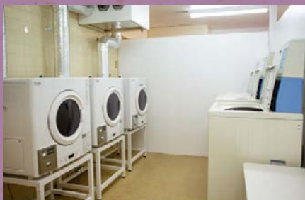
■ ランドリールーム(洗濯機・乾燥機各3台)
