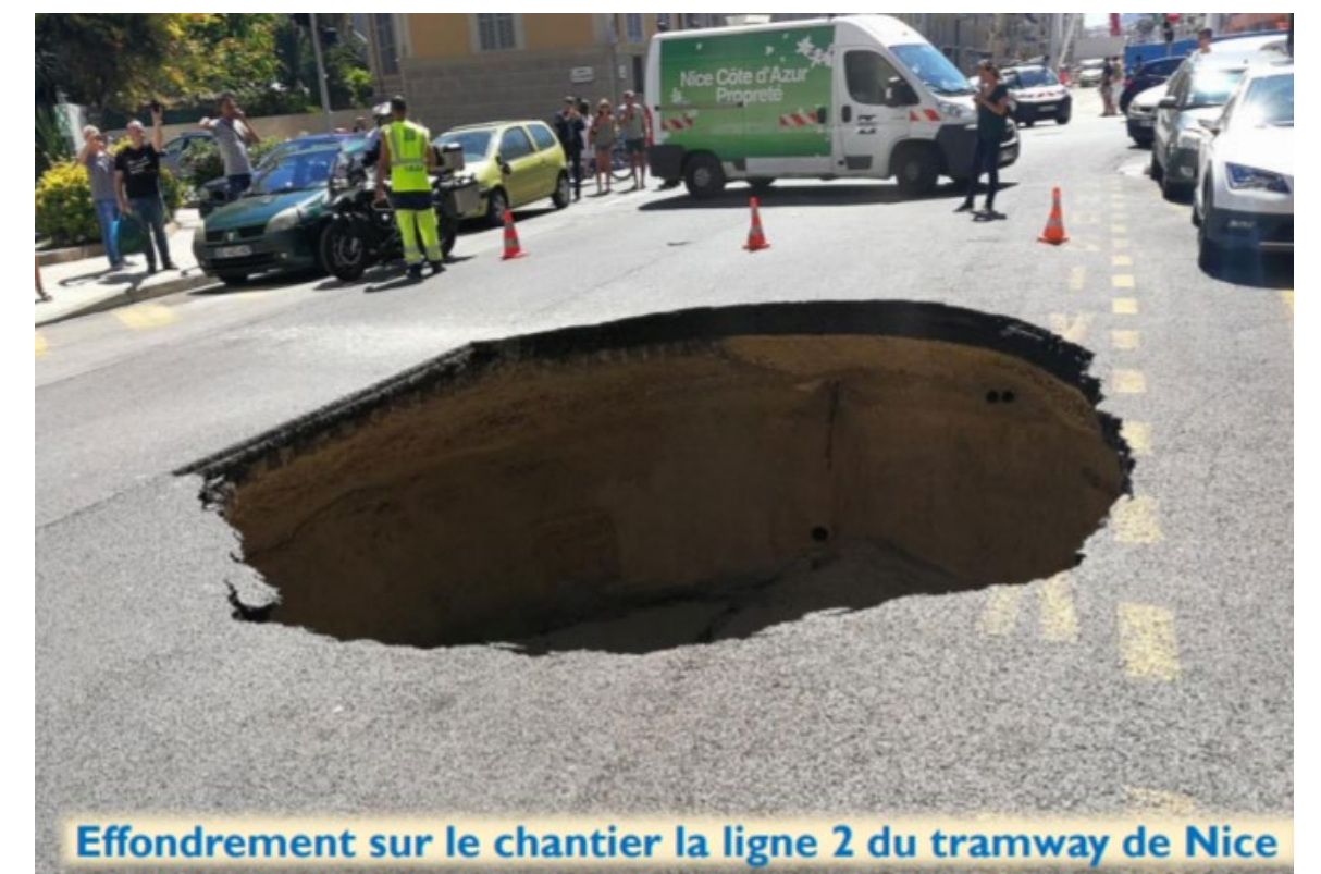
Effondrement sur le chantier la ligne 2 du tramway de Nice
