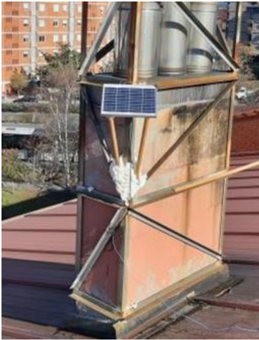
Figura 1: Fotografía da placa solar instalada no punto máis alto do instituto As Lagoas de Ourense.
