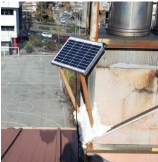
Figura 2: Fotografía da placa solar instalada no tellado do IES As Lagoas de Ourense.
